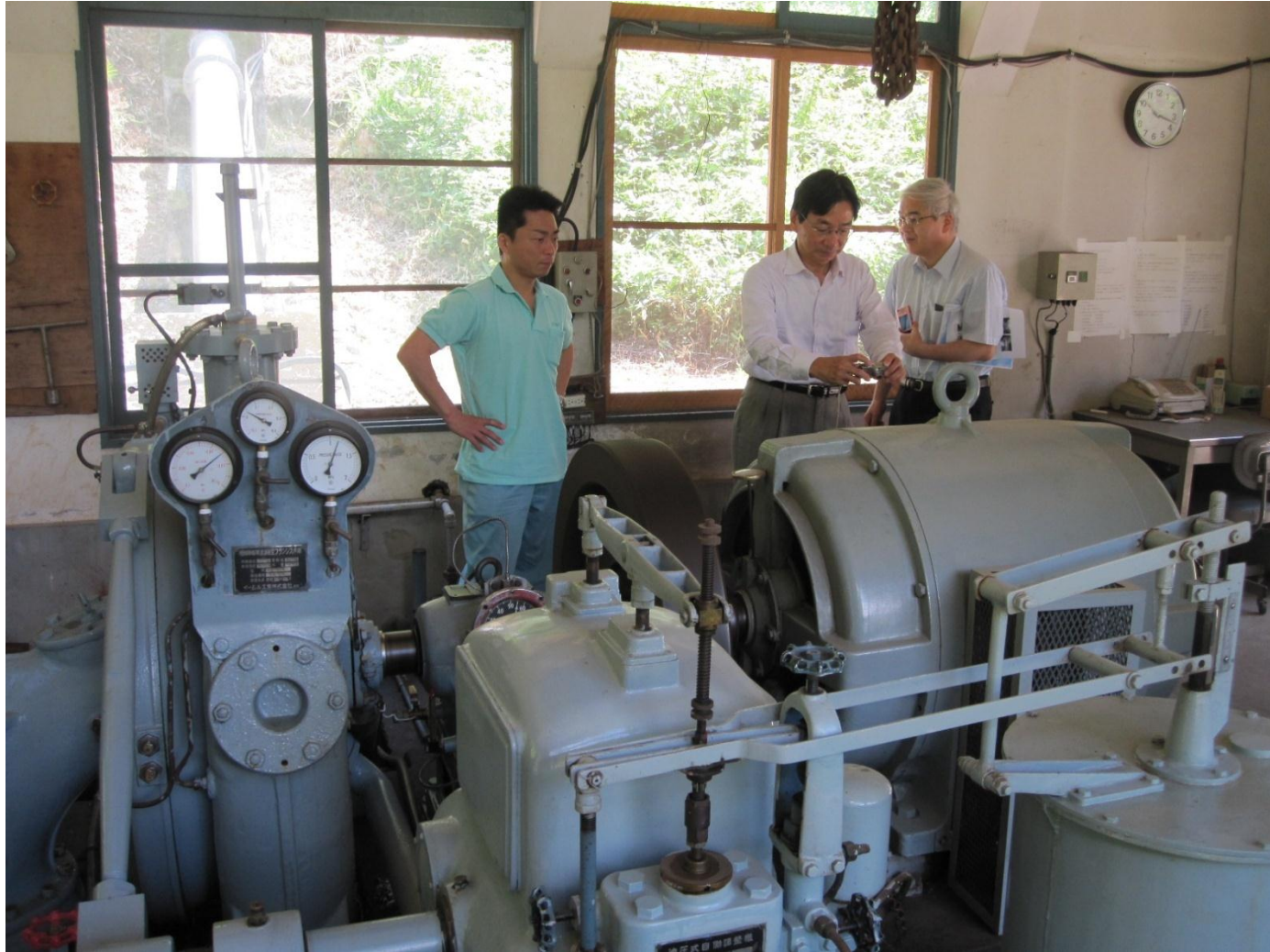
所山発電所建屋内部(発電機、タービン<水車>)
