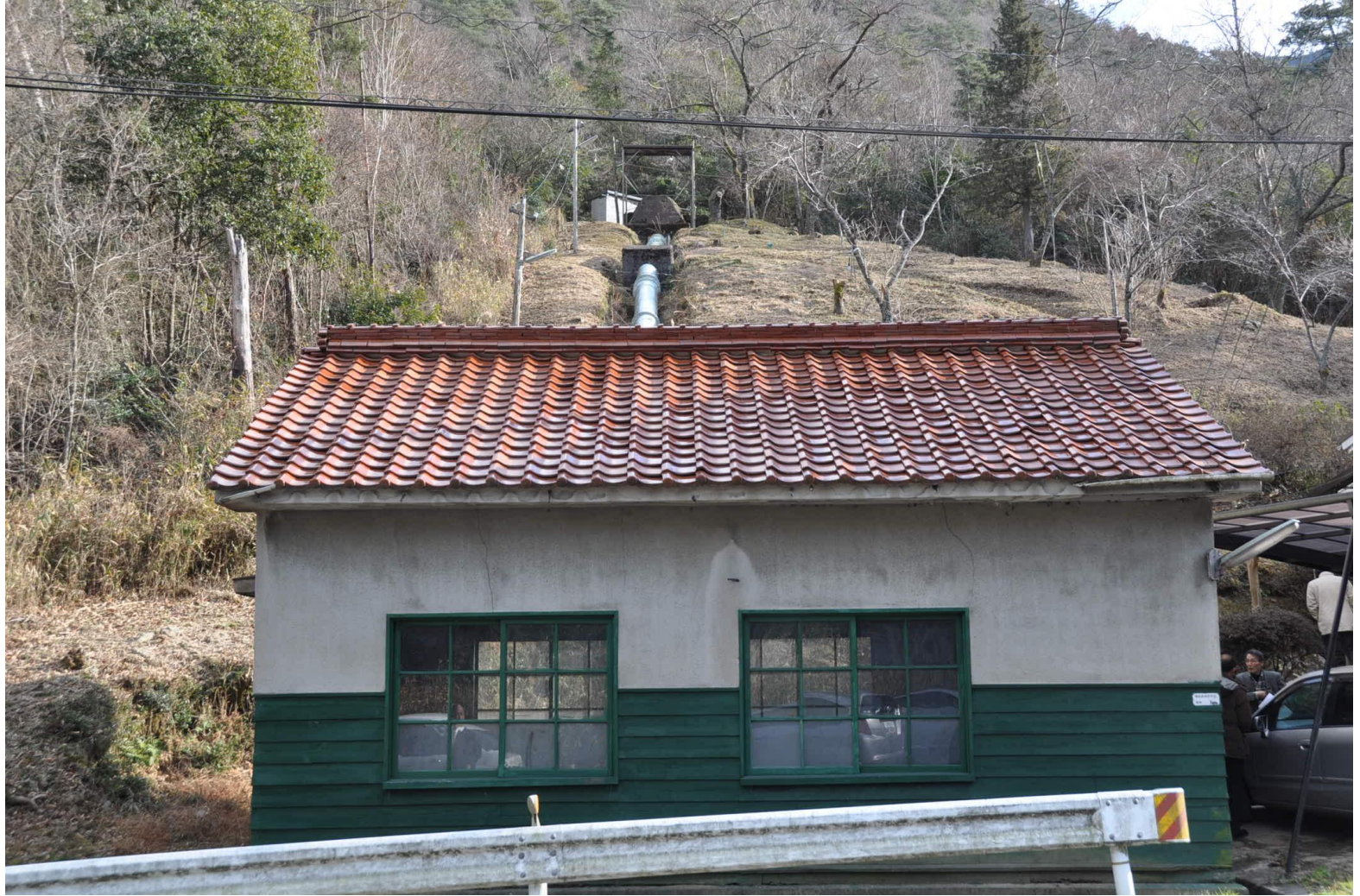
広島県東広島市志和堀(志和堀発電所)の 水圧鉄管と建屋
