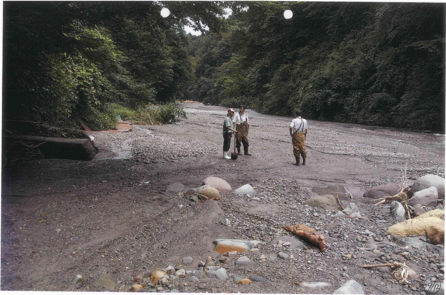
鳥取中央館内・・・昨年の台風12号により大山の土砂崩れの残土が河川に流入し、川床を1.5mも底上げされ、取水口も埋まってしまった様子。
