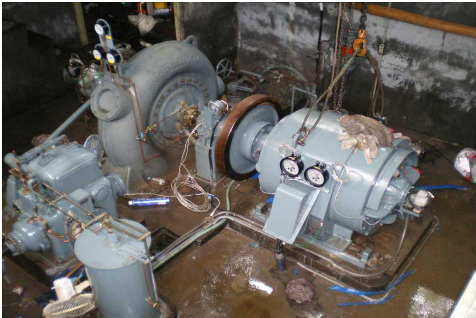
安木市～昨年の台風12号で、水没した発電所建屋内の様子・・・現在も停止中
